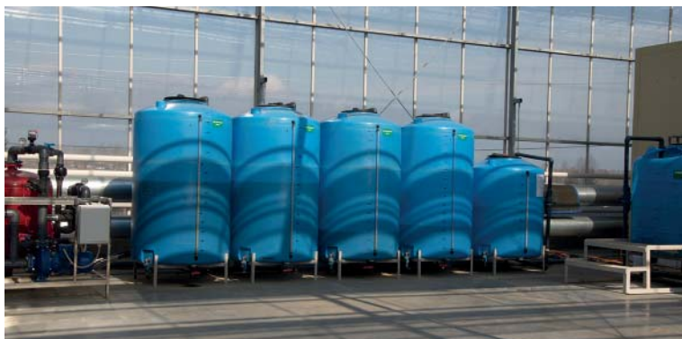
Фото 3. Оборудование для подкормки CO2
